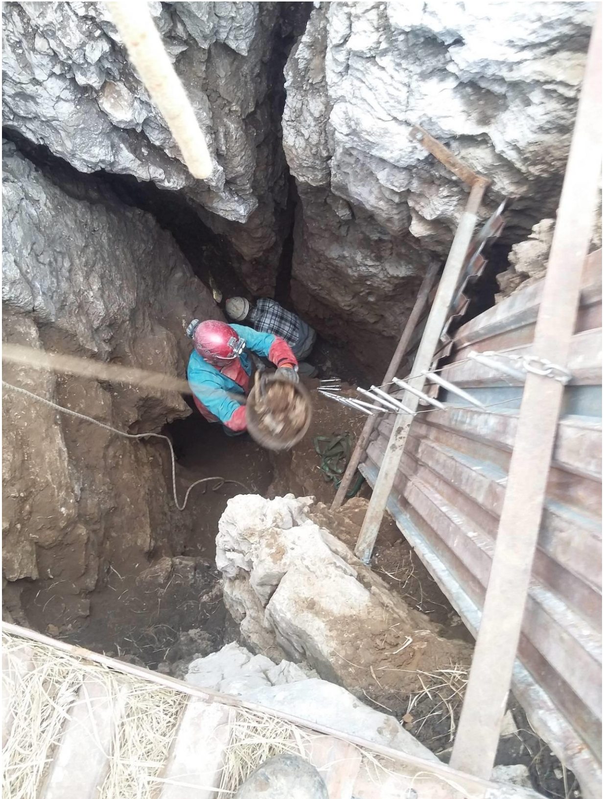
La SAS en cours de construction (parois en béton naturel 100% bio et complètement équilibré en bilan carbone)
