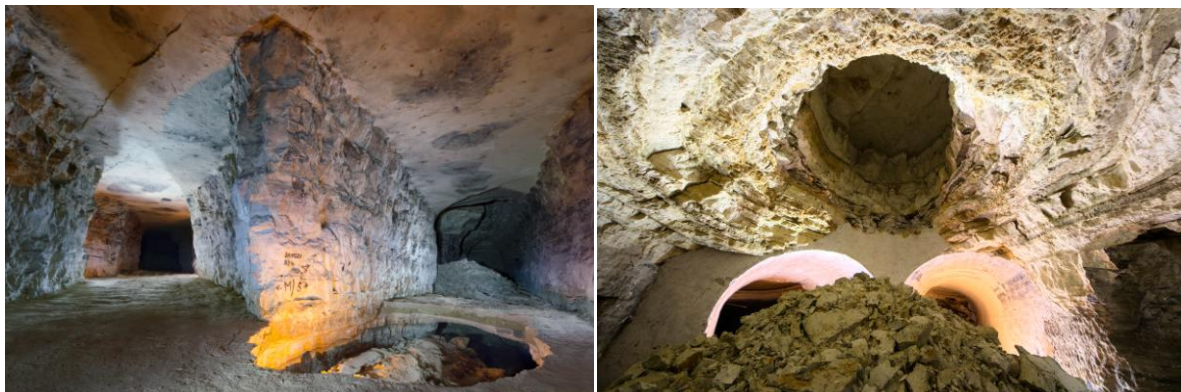
Gauche : Un désordre de seconde masse ayant atteint la première ; le pilier s'effrite alors copieusement... Droite : En seconde masse, une cloche remonte patiemment, le banc séparatif de marnes est déjà entamé.
