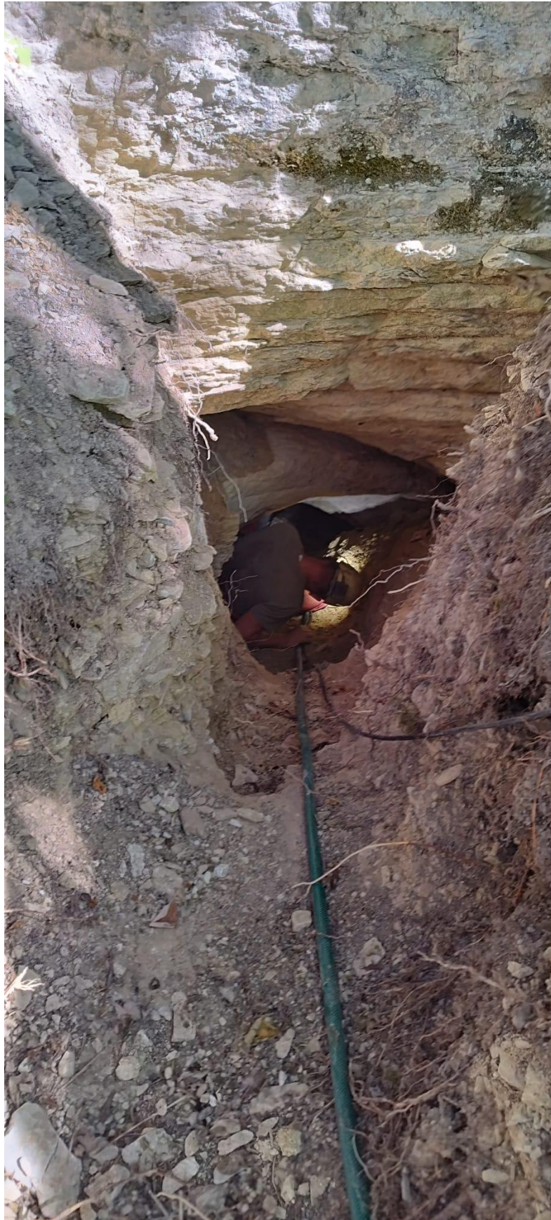
Figure 1: première opération de pompage
