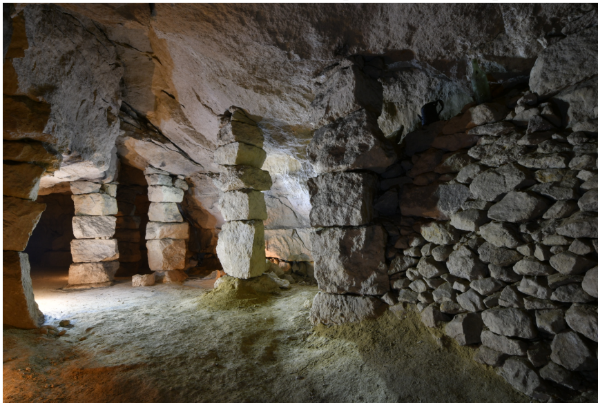
Piliers à bras dans la grande salle du niveau inférieur. Chacun de ces piliers soutient de gros blocs qui se sont désolidarisés du ciel calcaire.
